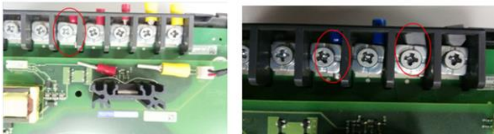
Figure 1-1 下图为使用针型接线端子不规范压接示例
