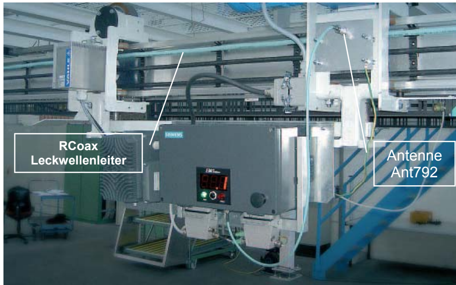
Einschienehängebahn als Beispiel einer IWLAN/RCOAX-Anwendung
