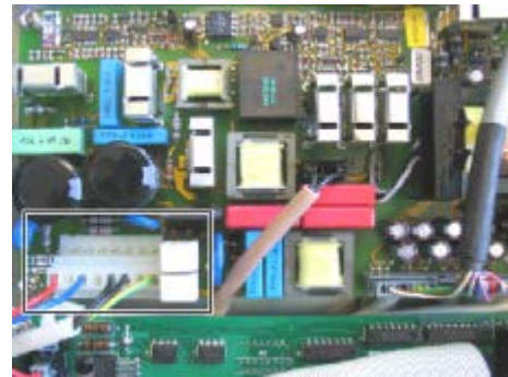
Schaltnetzteil mit Stecker auf externer Steuerungsspannung
