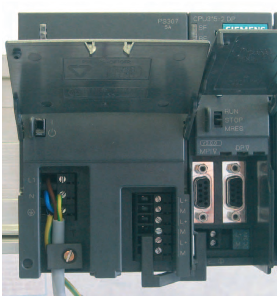
Bild 5-1 Verdrahtung der Stromversorgung und CPU
